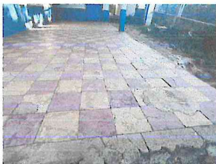
Foto 1: Corredor de Aula 1 y 2, piso de cemento liquido en mal estado.
