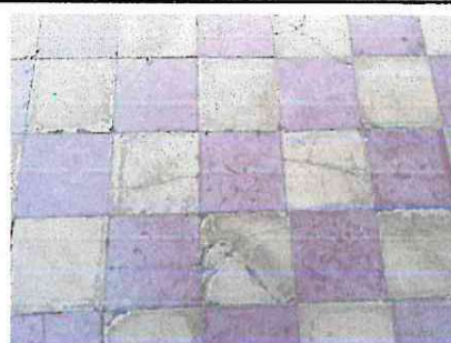
Foto 6: Piso aula 1, en mal estado
